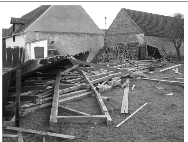
Stržená střecha kabin
